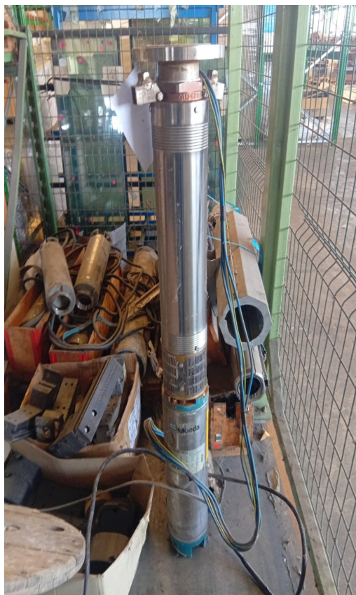
CARATTERISTICHE POMPA INSTALLATA
