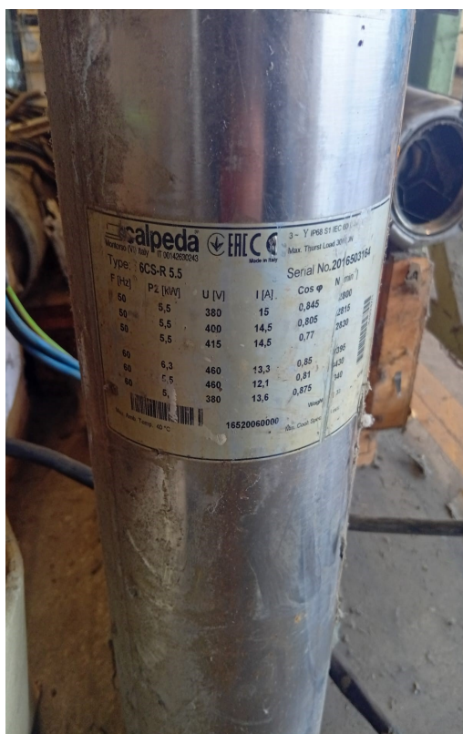
CARATTERISTICHE POMPA INSTALLATA
