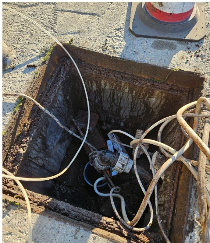
Figura 14 pozzetto carrabile, cameretta di avanpozzo e testata pozzo
